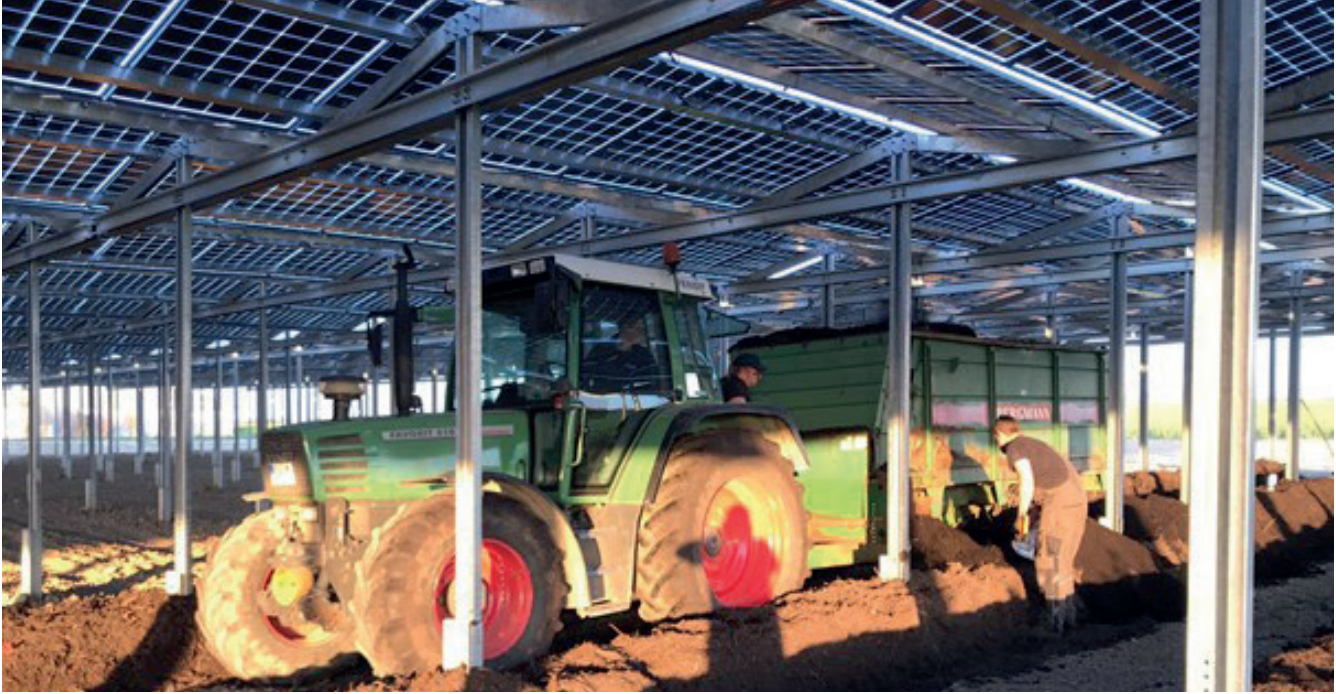
Abb. 52: Arbeiten in einer Agri-PV Anlage unter den Solarmodulen. © Fabian Karthaus.
